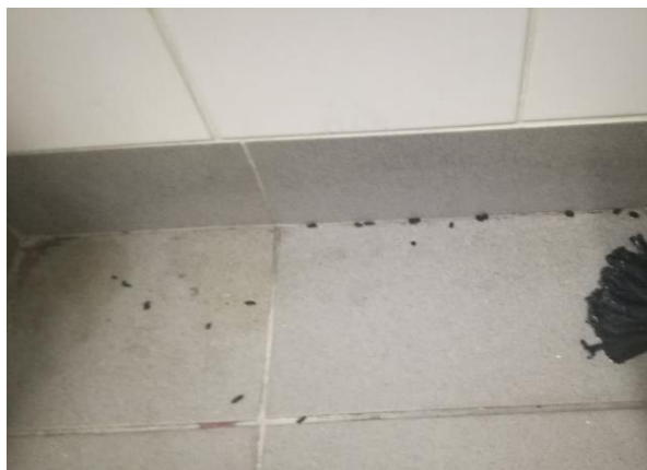
Figura 5 Fezes de roedores, dentro das instalações.
