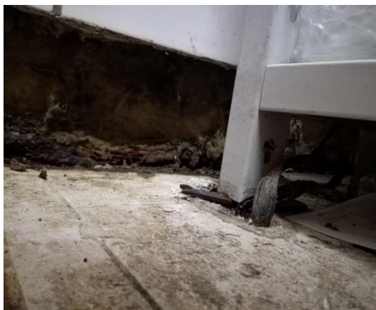
Figura 7 Dano localizado na parede do armazém.
