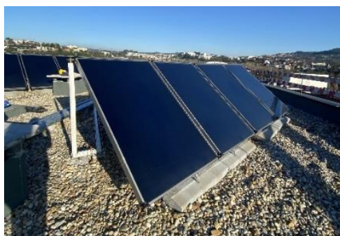
Figura 20 – Representação dos coletores solares térmicos na cobertura do hotel.
