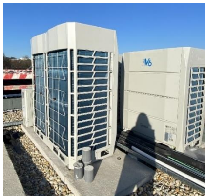
Figura 18 – Representação de dois VRV na cobertura da instalação.
