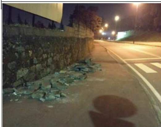
EPVNR16 – “Passeio Ocupado e perigo de queda e muro.”
