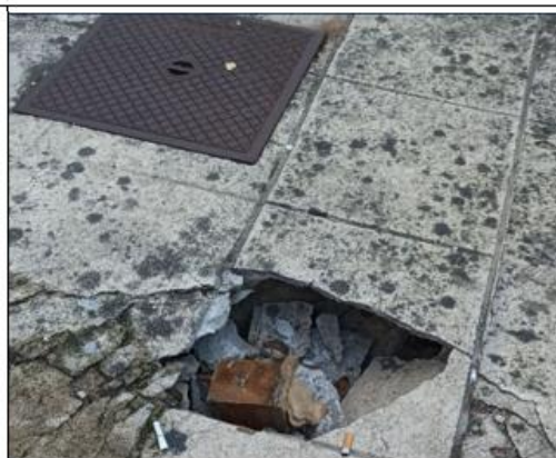
EPVNR19 – “Existe uma grande quebra no passeio perpendicular ao prédio onde vivo, já há algumas semanas. Esta quebra deu origem a um grande buraco que, da maneira como se encontra atualmente, pode levar a que alguém se magoe com gravidade. O passeio não é muito largo e não há grande visibilidade para o buraco, principalmente à noite, porque a iluminação não cobre tanto essa zona do passeio.”
