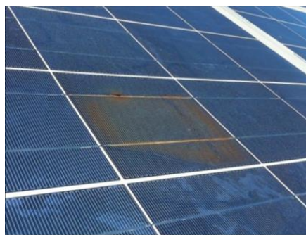
Figura 32 - Painel solar fotovoltaico danificado devido à formação de um " hotspot " (Sun et al., 2022).
