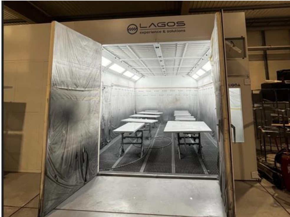
Figura 58 - Cabine de pintura nas instalações da Vieira&Lopes
