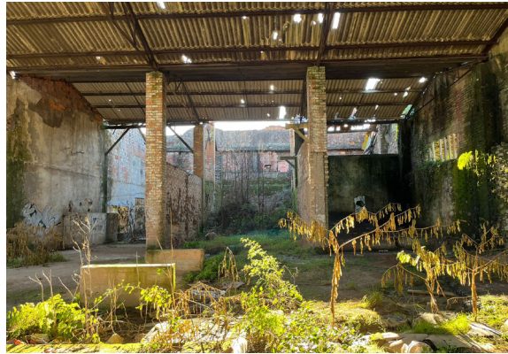
Figura 42: Degradação e crescimento de vegetação espontânea.
