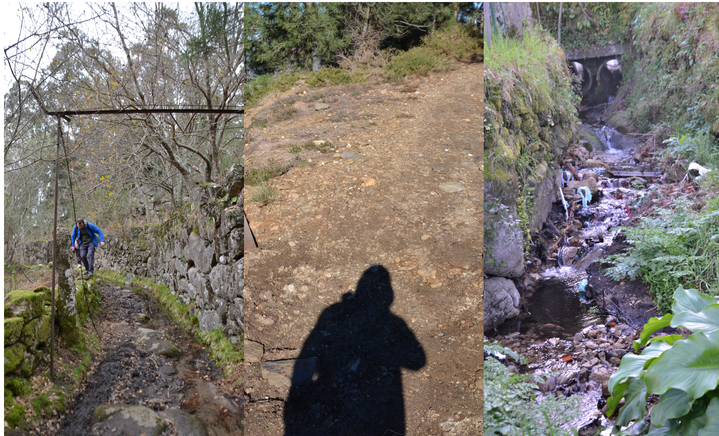
DEGRADAÇÃO DO PISO
