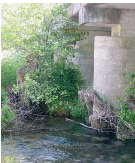
e) Wood debris retidos pelos pilares da ponte. Tregosa.
