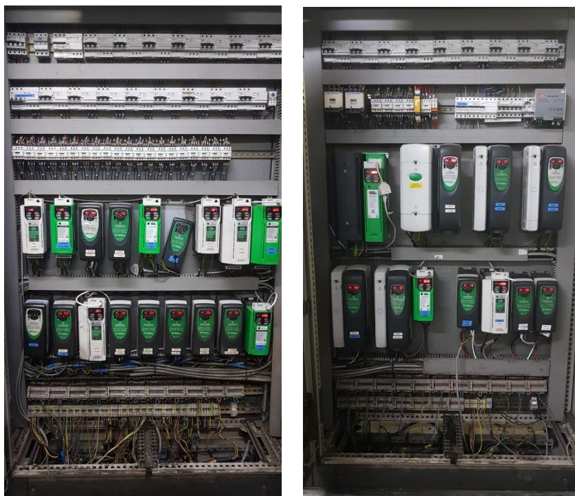
Figura 34 - Variadores de frequência dos motores elétricos das bombas
