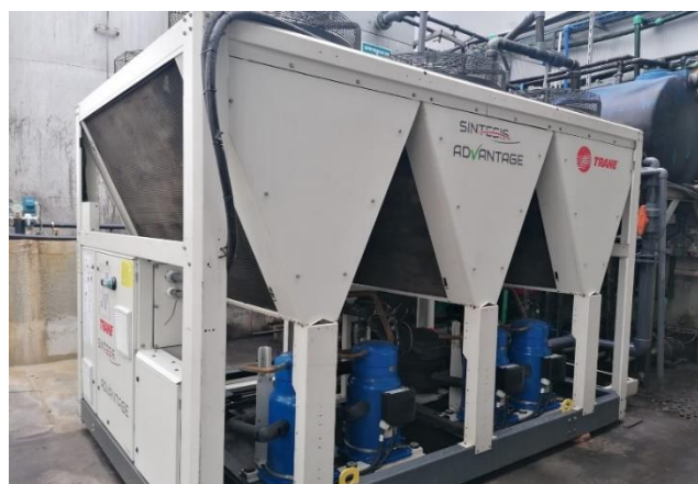
Figura 41 - Chiller utilizado na Bioport
