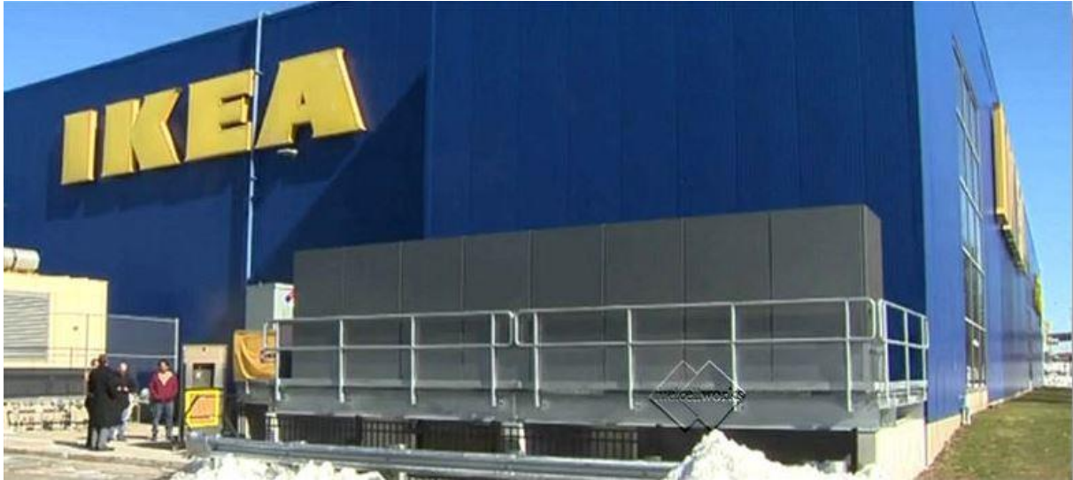
Figura 57 - Célula combustível instalada numa loja IKEA [26]
