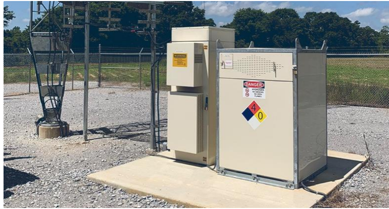
Figura 58 - Célula de backup energético a hidrogénio [37]
