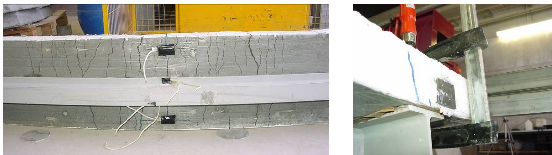
Figura 10 – Fendilhação distribuída na face inferior da laje e deslizamento aço-betão sobre o apoio
