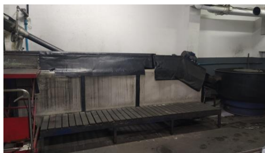
Figura 31 - Máquina de lavagem de esferas existente no piso -1 do pavilhão 1
