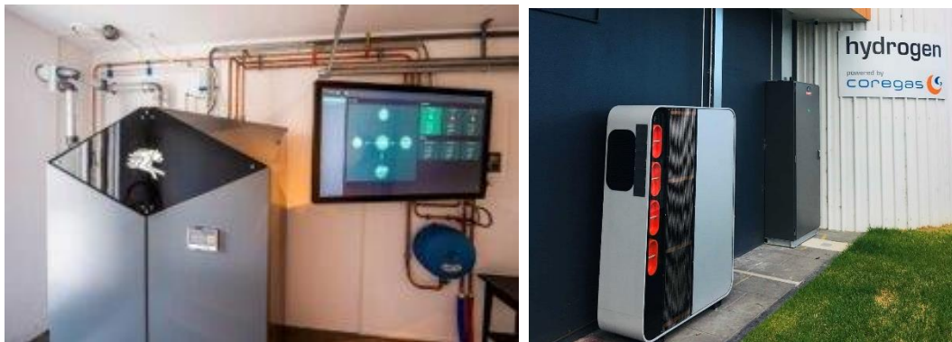
Figuras 5 e 6: Sistemas de armazenamento em forma de hidrogénio para pequena escala (Solenco Powerbox e Lavo) [7,8]
