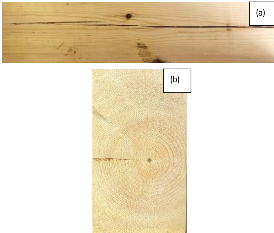
Figura 2.9 - Fendas de secagem. (a) Vista lateral de uma viga; (b) Vista frontal.
