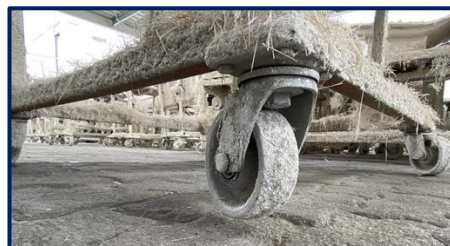
Figura 44- Desnivelamento do piso
