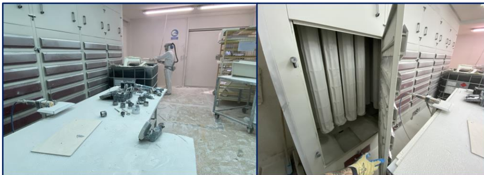
Figura 41 - Sistema de extração na cabine de corte
