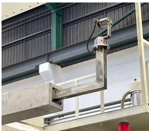
Figura 18 - Sensor fotoelétrico para verificação de peças incompletas
