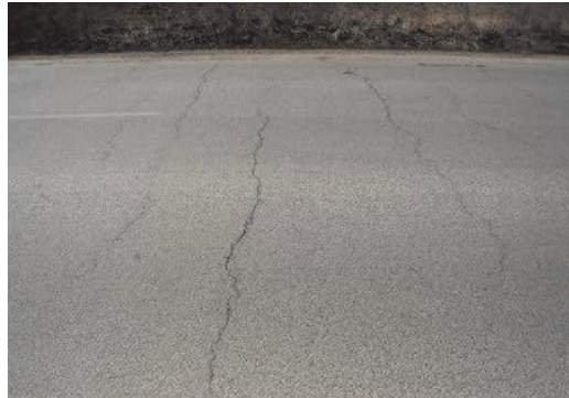
Figura 2.3 - Fendilhamento térmico em um pavimento semi-rígido (Vaitkus et al. , 2012)
