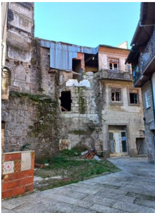
Figura 12 - Exemplo de um edifício abandonado na Rua do Anjo
