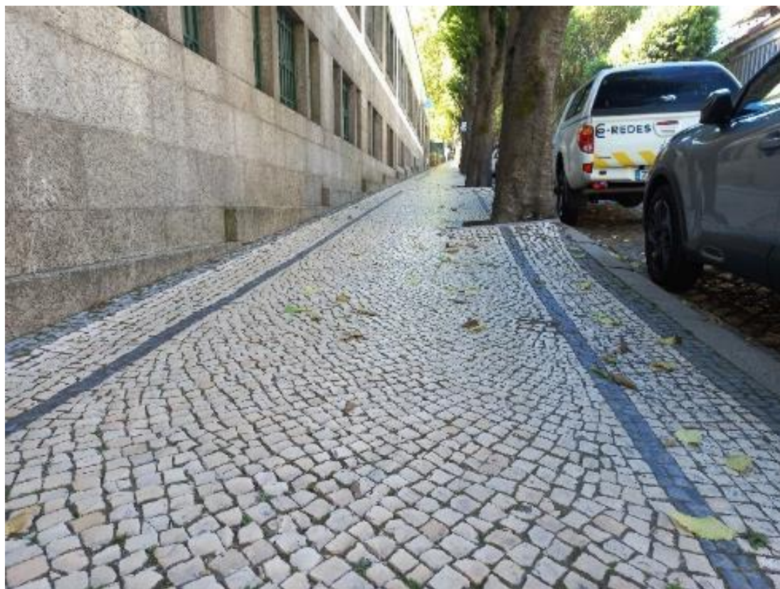
Figura 23 - Deformação do pavimento devido a raízes das arvores na Av. Dom Afonso Henriques
