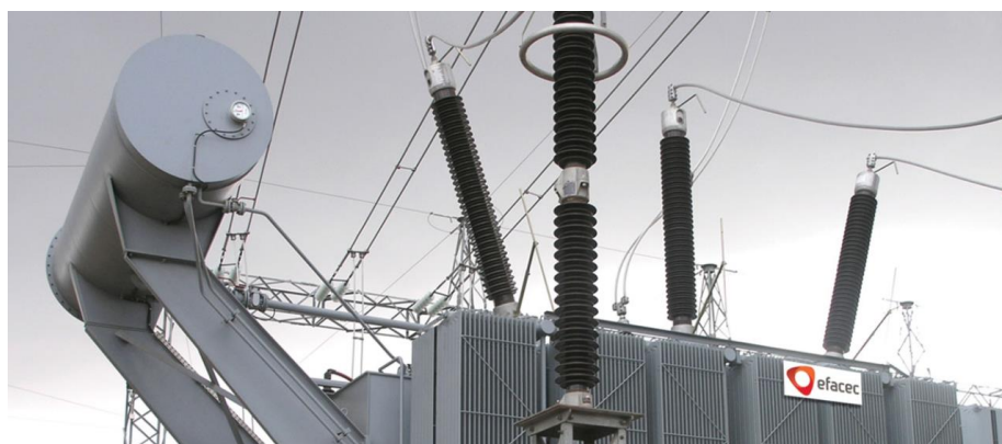
Figura 6 – Transformadores de potência
