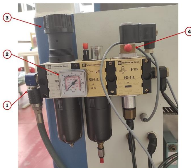
Figura 63 - Unidade de tratamento de ar da fresadora
