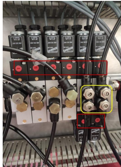
Figura 64 - Bloco de electroválvulas do sistema pneumático da fresadora
