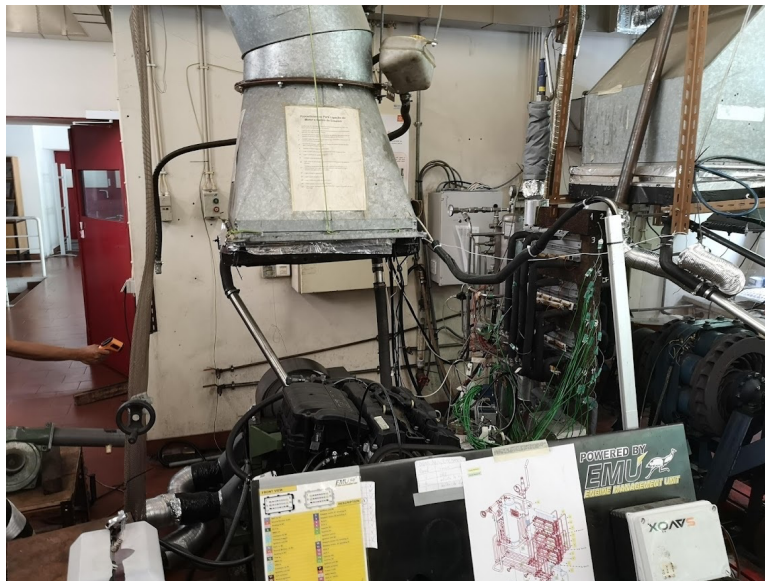
Figura 39 – Foto da instalação
