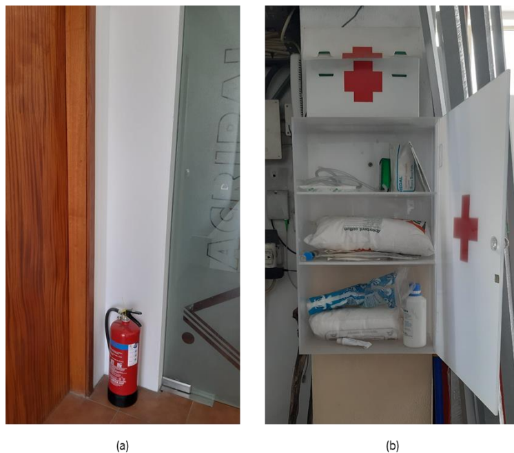
Figura 14 – Exemplo de um (a) extintor inutilizável, incorretamente posicionado, sem sinalética identificação e (b) primeiros socorros desatualizados
