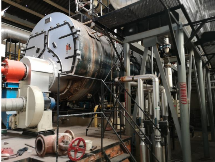
Figura 42 - Caldeira de vapor 1 instalada na central térmica
