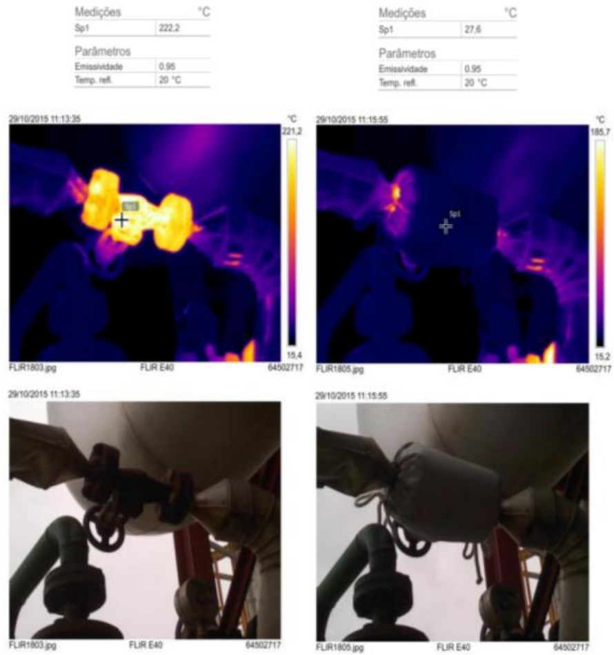
Figura 115 - Exemplo de resultados obtidos da implementação de isolamento térmico do tipo “valve jacket”
