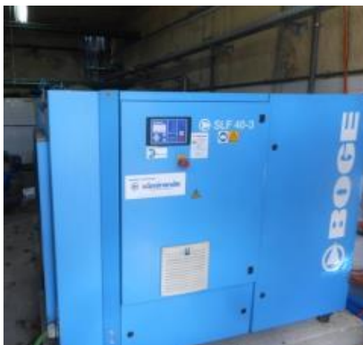
Figura 38 - Compressor 1 utilizado na central de ar comprimido
