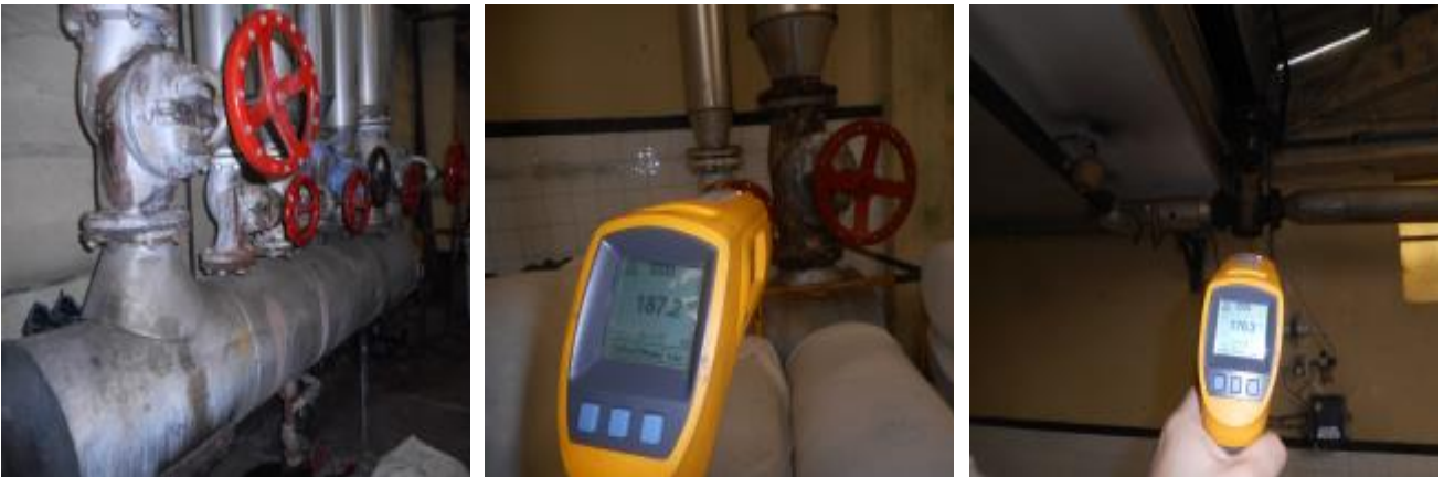
Figura 114 - Exemplos de válvulas e troços de tubagens da instalação desprovidos de isolamento térmico
