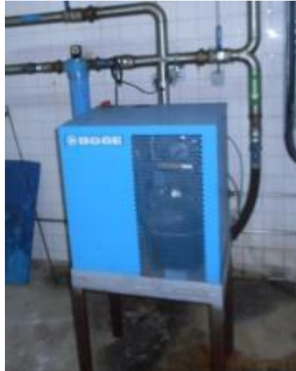
Figura 40 - Secador de ar utilizado na central de ar comprimido
