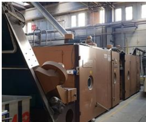
Figura 31 - Tumbler utilizado na instalação
