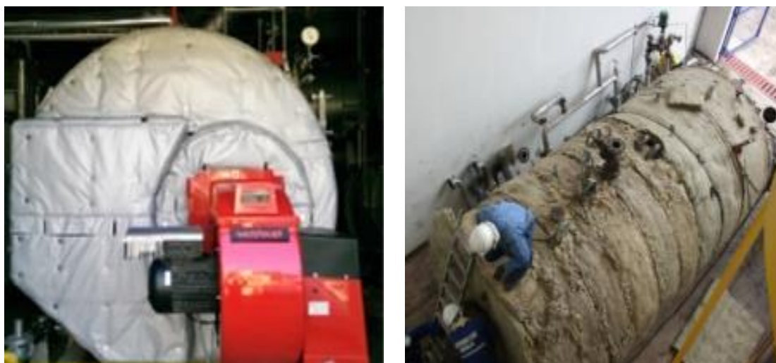
Figura 110 - Exemplos de caldeiras isoladas com lã de rocha
