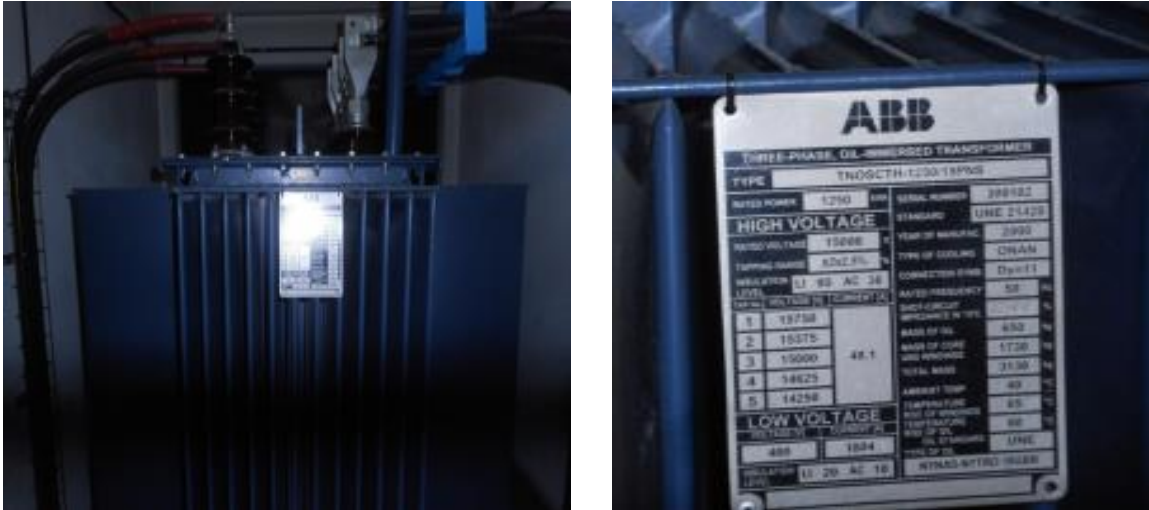
Figura 33 - Transformador ABB de 1 250 kVA e respetiva chapa de características
