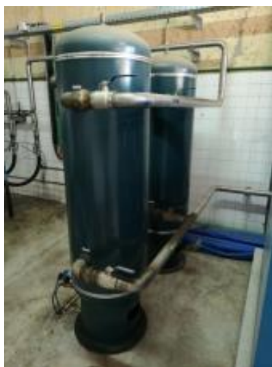
Figura 39 - Depósitos de ar comprimido instalados na central
