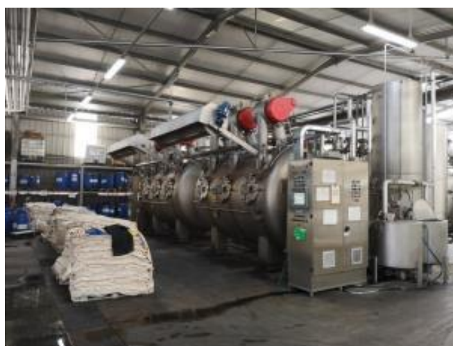
Figura 26 - Jets instalados na tinturaria nova
