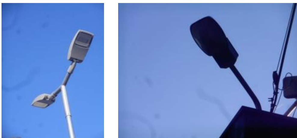
Figura 45 - Exemplos de luminárias aplicadas para iluminação exterior da instalação
