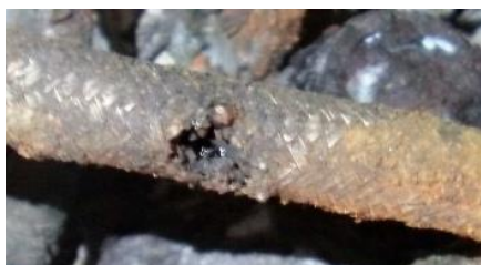
Figura 3-107 - Tubo de óleo com furo e mostras de ter sofrido elevado aquecimento.
