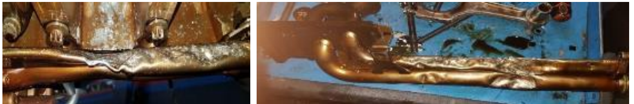
Figura 3-47 - Tubos de óleo situados no cárter amassados e com diversos danos resultantes de impactos.
