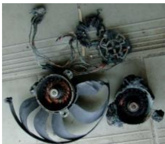
Figura 3-108 - Os dois motores elétricos dos ventiladores dos radiadores.
