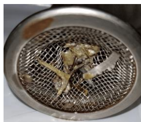
Figura 3-23 - Filtro de aspiração da bomba colmatado.
