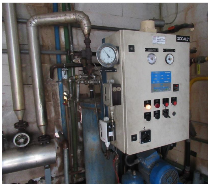
Figura 18 – Painel de controlo do gerador de vapor.
