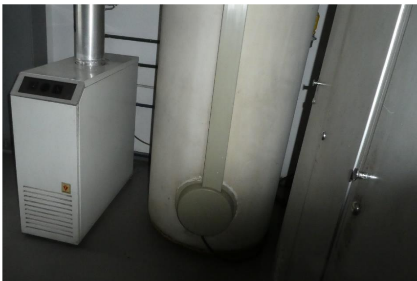
Figura 15 – Imagem da caldeira AQS com depósito de acumulação.
