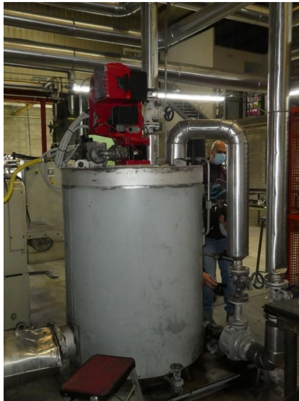
Figura 17 – Gerador de calor.
