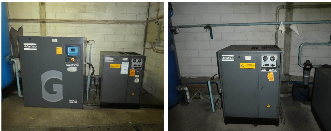
Figura 21 – Imagens dos compressores de ar comprimido.
