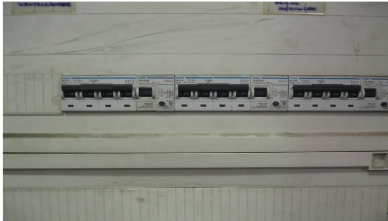
Figura 24 – Exemplo de circuitos sem identificação.
