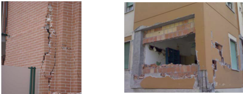
A Figura 3 apresenta exemplos de colapso de paredes com ligações deficientes ou inexistentes à estrutura de betão armado (Abreu, 2011)
