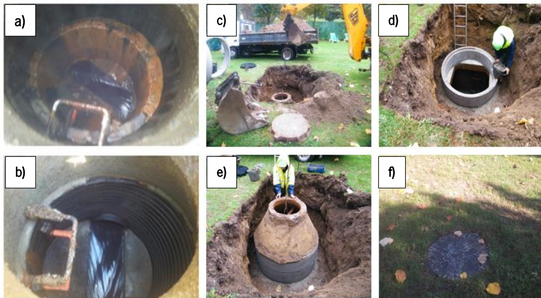
Figura 4-9: a) Câmara de visita com infiltração, b) Infiltração reparada e de c) a f) Elevação de câmara de visita enterrada.
