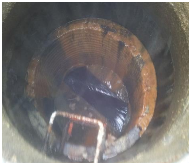
Figura 3-16: Detecção de câmara de visita com infiltração.
