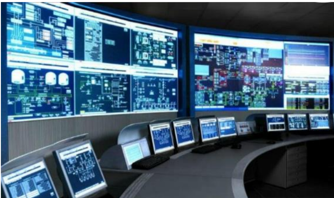
Figura 2-5: Vista de uma sala de controlo com écrans de um SCADA (DanielMiessler, 2016).
