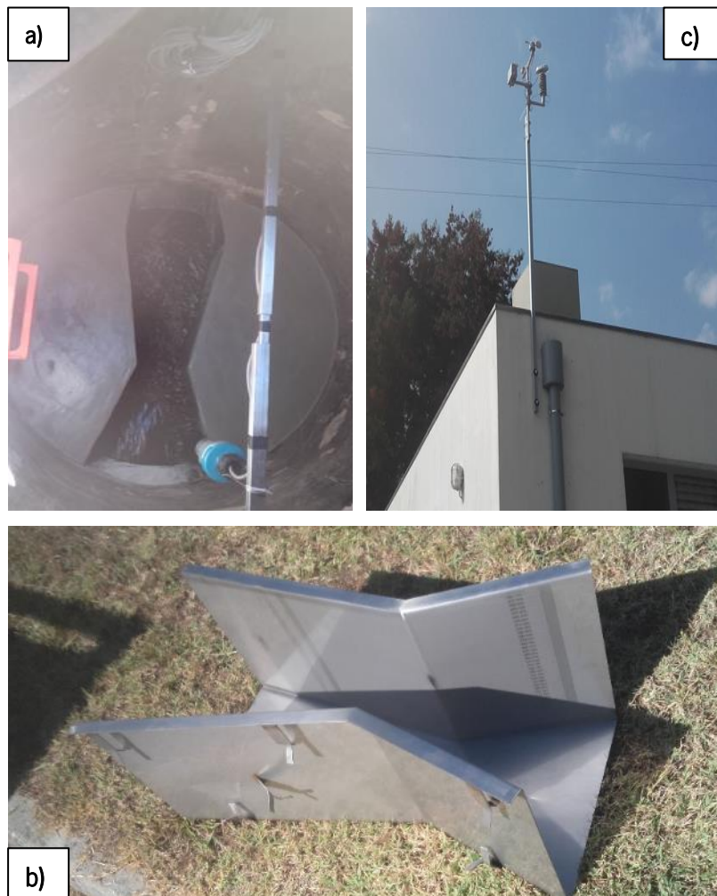
Figura 3-23: a) Câmara de visita com instalação de canal cutthroat , b) canal cutthroat antes da colocação na câmara de visita e c) exemplo de instalação de estação meteorológica.
