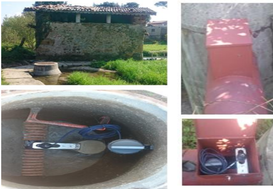
Figura 3-21: Estruturas criadas para colocação de sensores de monitorização em interceptores.
