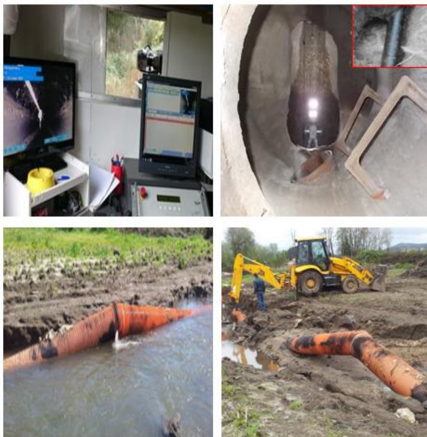
Figura 4-4: Exemplo de anomalia DEI identificada através dos resultados de monitorização contínua e posteriormente reparada.
