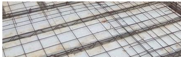
Figura 41: Treliças (Base de concreto e as treliças sem a capa de concreto) (FA3)
