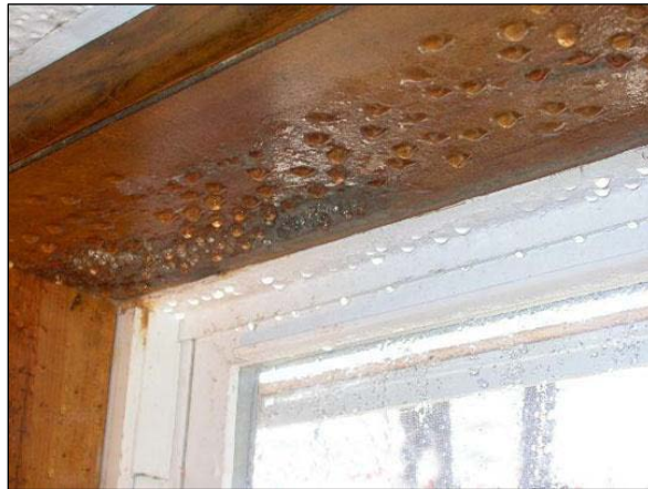
Figura 2.2 Condensação de água em janela (Silva et al., 2013).
