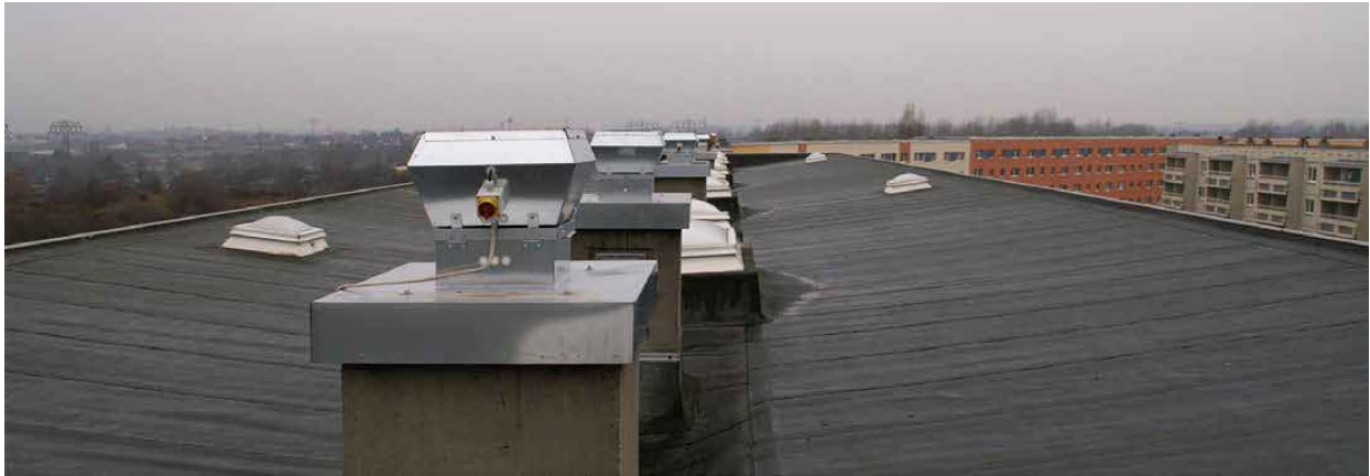
Figura 2.44. Sistema de VMEC em ambiente externo (Aereco, 2020).
