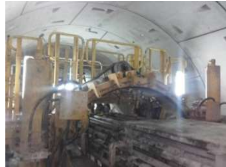
Fig.245-Plataformas de trabalho de tuneladora [206]
