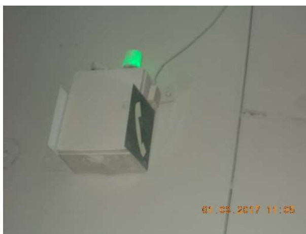
Fig.60-Telefone no interior de túnel [58]
