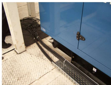
Fig.111- Instalações elétricas da tuneladora [127]
