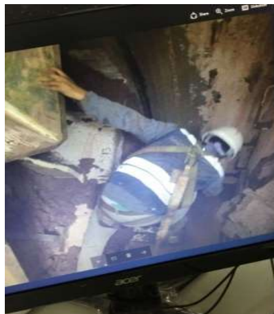
Fig.43-Intervenção em discos de corte [206]
