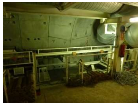
Fig.121-Mangas rígidas de ventilação [58]
