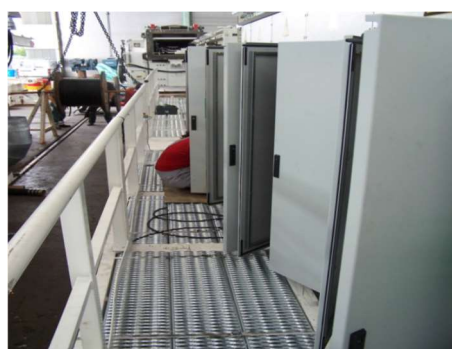
Fig.142-Quadros elétricos em tuneladora [127]
