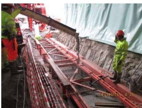
Fig.206-Resíduos de betão em cofragem [31]
