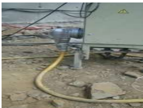
Fig.110-Cabo elétrico sujeito a dano [31]
