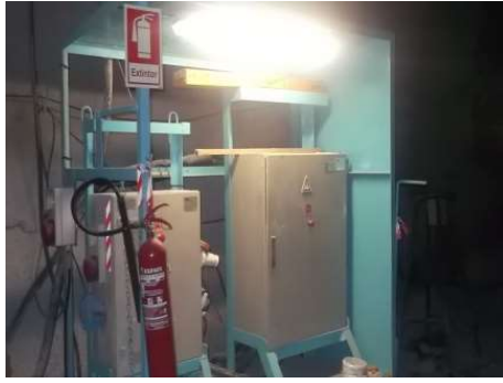
Fig.159-Quadro elétrico junto a face de escavação [31]
