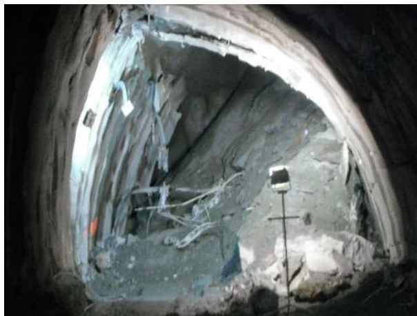
Fig.80-Derrocada junto a face de escavação [277]
