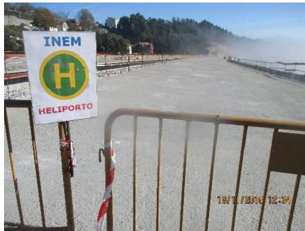
Fig.73-Local reservado para heliporto [31]
