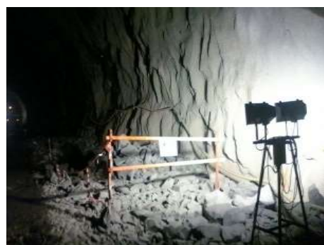
Fig.114-Projetor de iluminação provisório [31]
