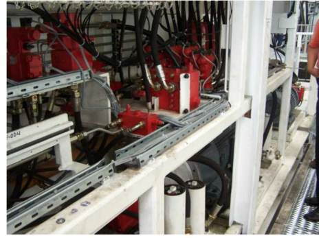
Fig.160-Instalações elétricas em tuneladora [127]
