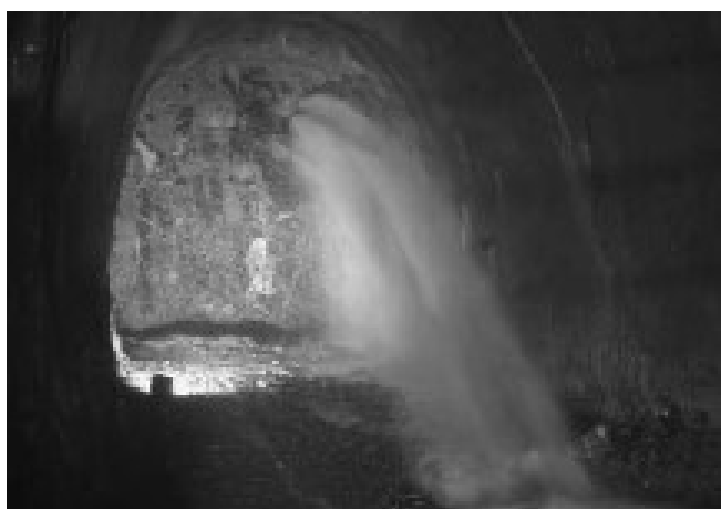
Fig.81-Afluência de água a frente de escavação [310]
