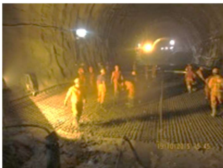
Fig.344-Trabalhadores muito próximos entre eles [31]
