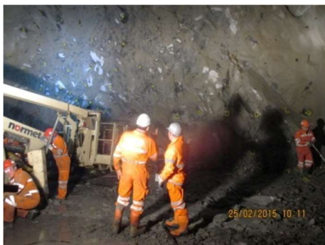
Fig.342-Trabalhadores muito próximos de maciço [31]
