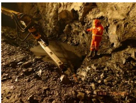
Fig.249-Pavimento com blocos soltos [31]
