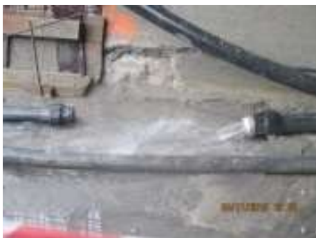
Fig.200-Tubagem em pressão danificada [31]
