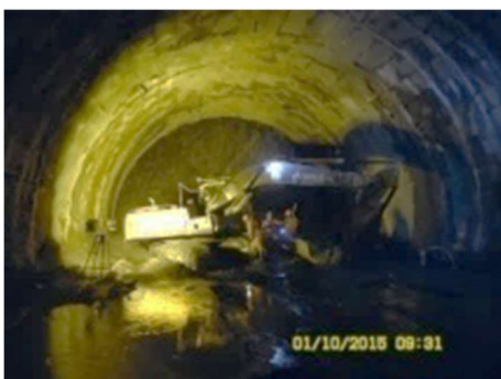
Fig.165-Ausência de separação face/zona trabalhos [31]
