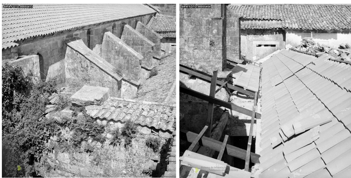
Figura 121 - Registo fotográfico da intervenção da DGEMN na década de 40 do século XX onde é possível observar a ausência de cobertura nas laterais da igreja. Fonte: monumentos.pt / CC BY-NC-ND-3.0.
