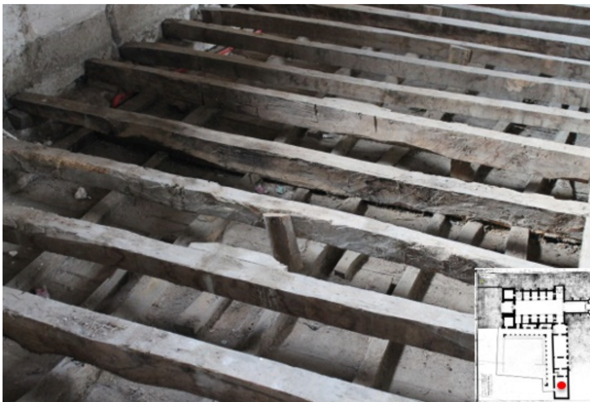
Figura 180 - Pormenor do tipo de vigas serradas do pavimento da parte norte do piso superior da ala este do claustro sul.
