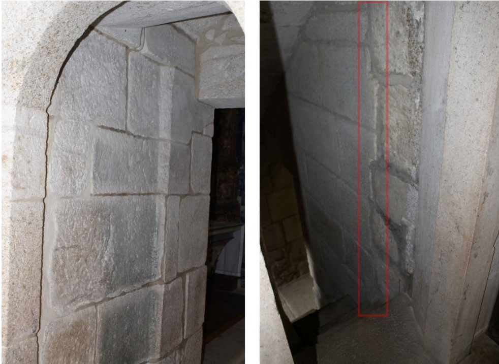
Figura 105 – Pormenores da homogeneidade construtiva do ponto 1 e do interface de rotura identificado no ponto 2.
