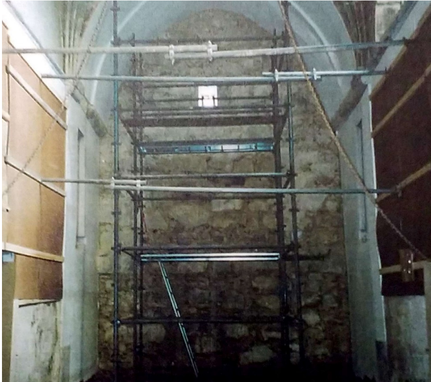
Figura 96 - Pormenor da parede norte da capela norte do transepto durante a intervenção de reabilitação. 132
