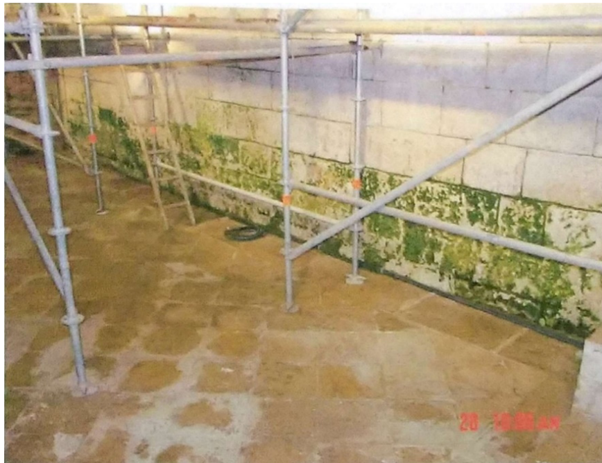
Figura 63 - Aspeto do pavimento antes da intervenção de correção das patologias provocadas pela saturação de humidade (Freitas, 2002, p. 10).
