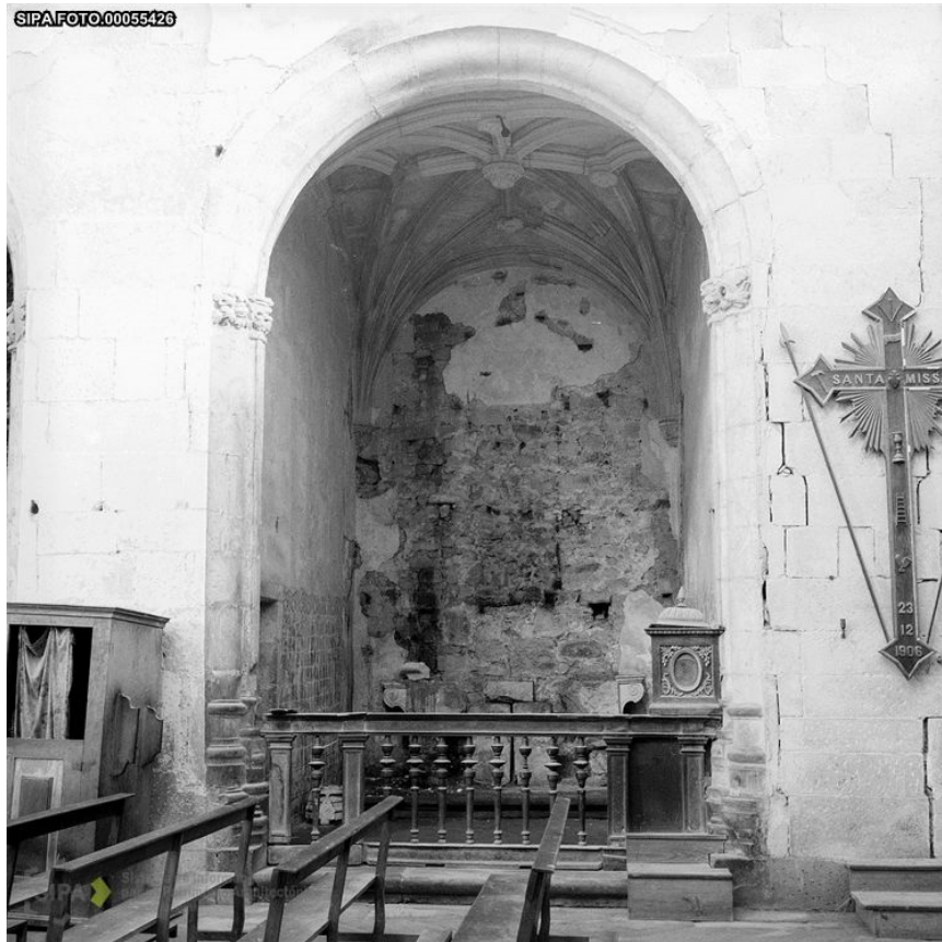
Figura 124 - Fotografia da DGEMN, não datada, onde é possível observar a existência de janelas entaipadas do século XVI na parede sul do corpo da igreja. Fonte: monumentos.pt / CC BY-NC-ND-3.0.
