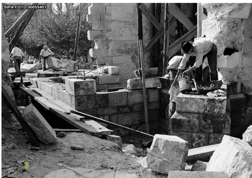
Figura 70 – Construção da parede fundeira com o anexo da tribuna e contrafortes diagonais durante a intervenção da DGEMN entre 1941 e 1945. Fonte: monumentos.pt / CC BY-NC-ND-3.0.
