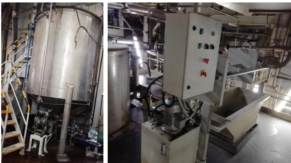
Figura 23 - Tanque de águas doces pobres com bomba pneumática instalada (à esquerda) e filtro de placas instalado (à direita).
