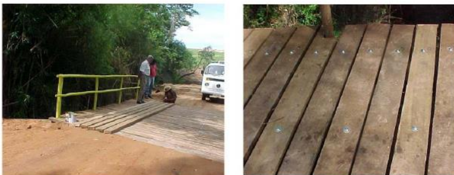
Figura 39 - Tabuleiros transversal e longitudinal de peças de madeira serrada. Fonte: Calil Junior 2006
