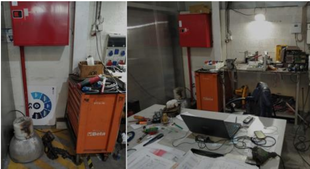
Figura 28: Falha na aplicação de 5S na área técnica
