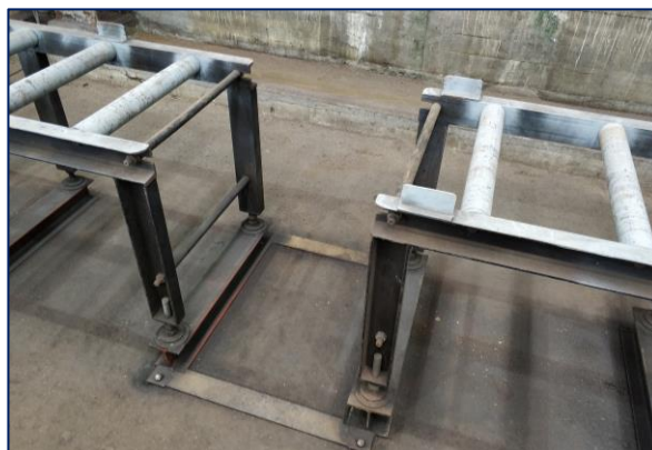
Figura 58: Corredor na mesa de rolos
