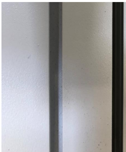
Figura 211 – Defeito na pintura
