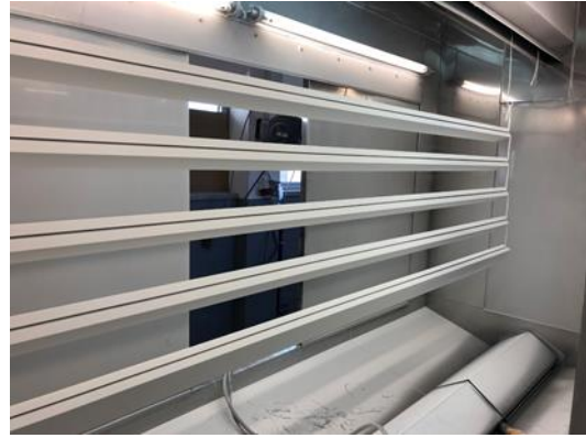
Figura 181 - Perfil na cabine de pintura
