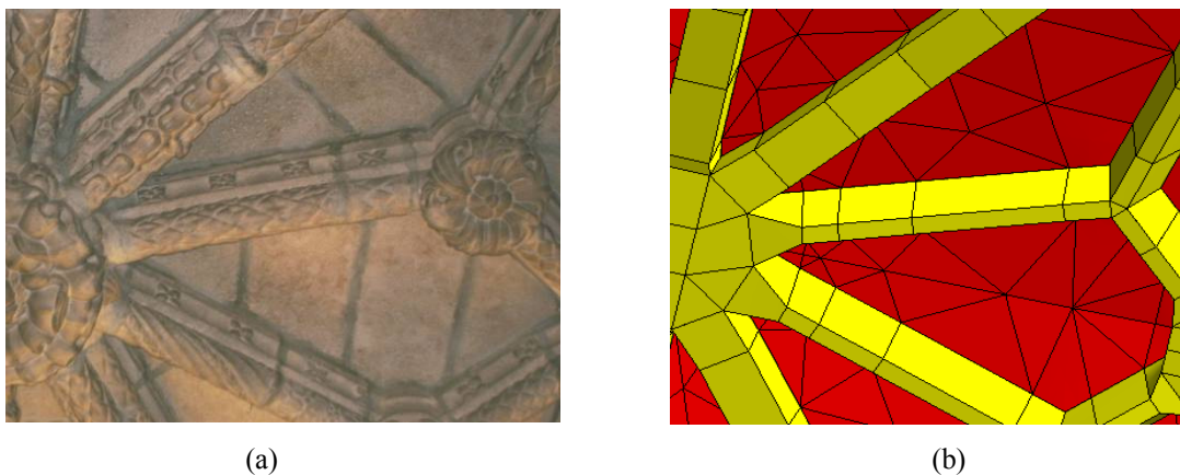
Figura 4.25 – Vista inferior das lajetas de pedra entre nervuras: (a) estrutura existente; (b) modelo 3D.
