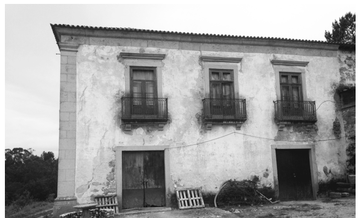
Fig. 94. Janelas de sacada no alçado Nordeste da Quinta de São Miguel
