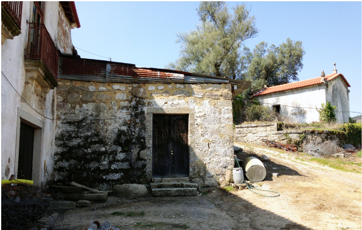
Fig. 39. A Casa, à esquerda, o V3 ao seu lado direito, e a Capela.
