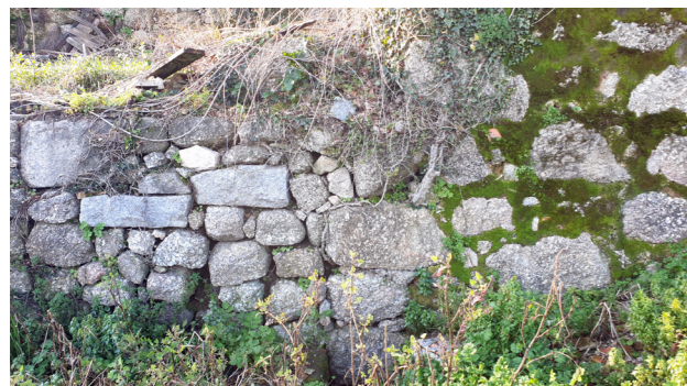
Pormenor da junção entre o V5 e o muro no piso inferior (Fachada Sudeste)
