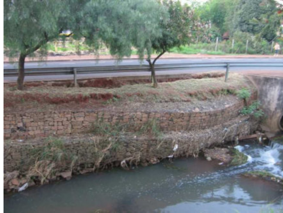
Figura 4: Córrego do Gregório, obra de contenção antiga sofrendo desabamento devido à erosão. (15/12/2009)
