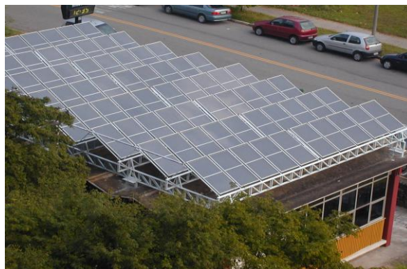
Fig. 5 Aquecedor solar do restaurante central (RU-CRUSP)
