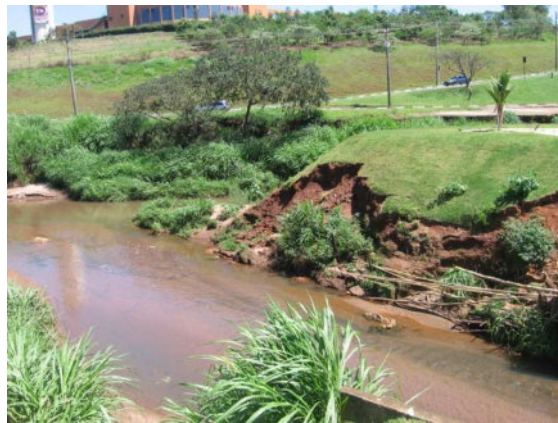
Figura 5: Foz do Córrego do Gregório no Córrego do Monjolinho, desbarrancamento das margens. (15/12/2009)
