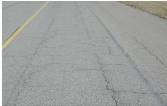
Fig. 2.1 Fendas longitudinais e transversais
