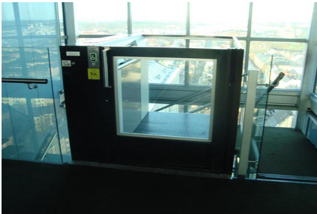
Fig. 7 – Elevador de restaurante na cidade de São Paulo.
