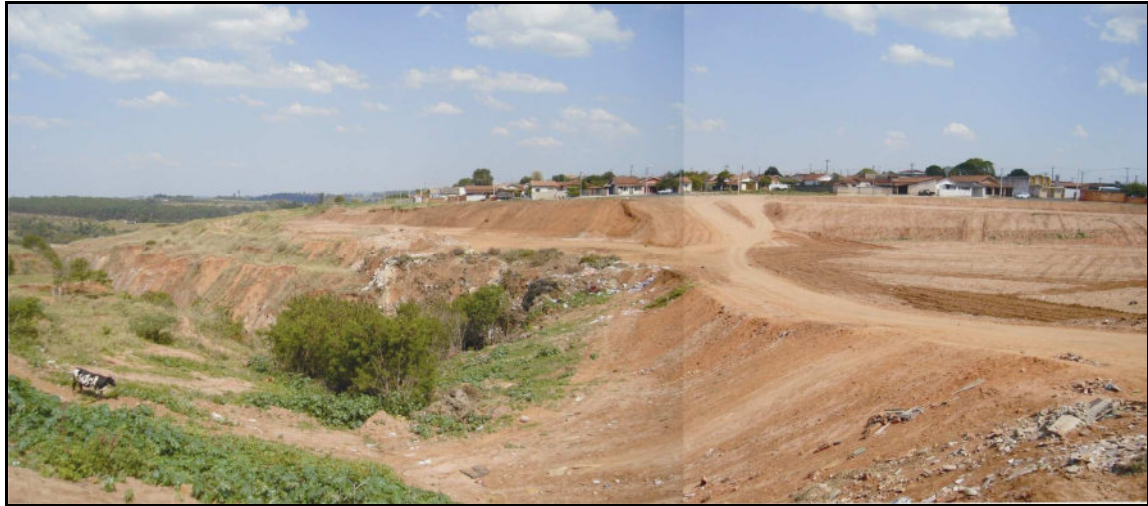
Fig. 02 – Cabeceira da voçoroca do córrego Tucunzinho e obras de terraplanagem
