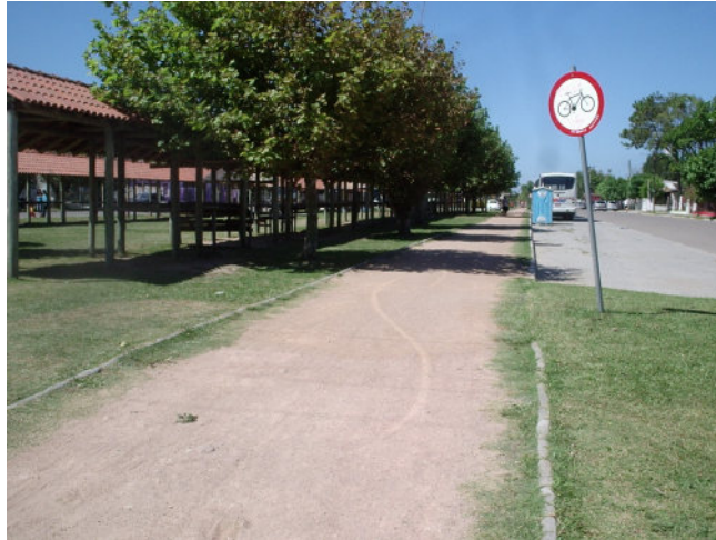
Fig. 2 – Foto da via com sinalização, mas sem piso adequado
