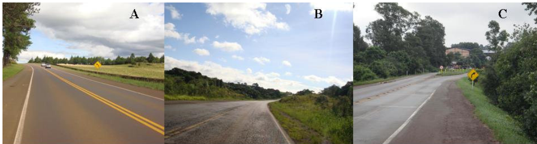
Fig. 7 Problemas na infra-estrutura da rodovia
