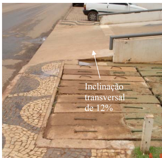
Foto 1: Inclinação transversal superior a 3%
