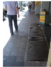
Figura 9 – Grelha com hastes acima do nível da calçada.
