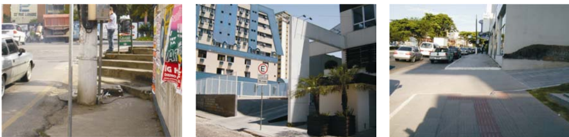
Fig. 1 Problemas nos passeios impedem a circulação de pedestres em geral
