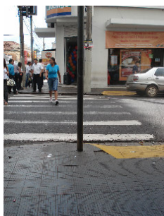
Figura 5a - Guia rebaixada fora da faixa de pedestre
