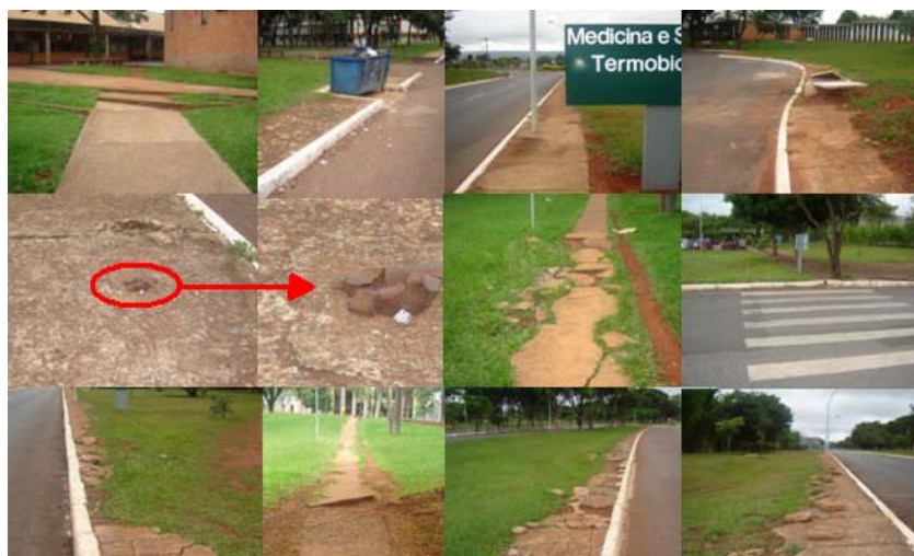
Figura 3 Alguns problemas encontrados nas calçadas do campus da UnB
