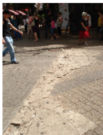
Figura 10 – Desgaste no piso do calçadão
