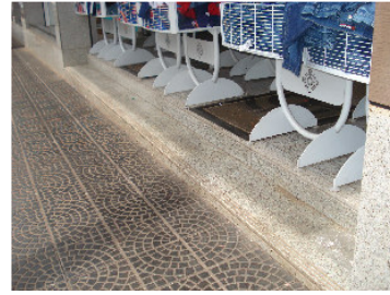
Figura 7 - Acesso prejudicado pelos degraus e estreitamento da passagem.
