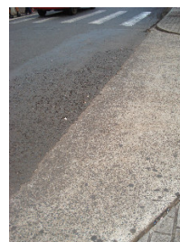
Figura 2 – Detalhe do asfalto irregular
