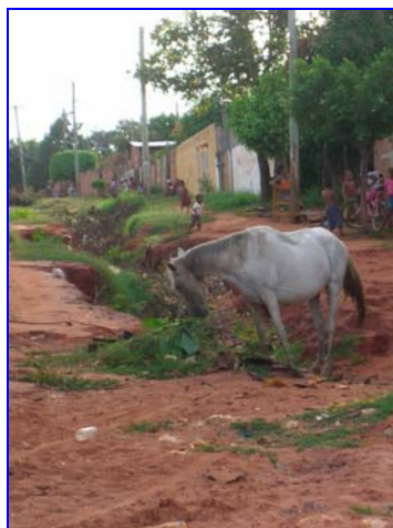
Imagem 1. Erosão no meio da rua, atraindo animais e causando doenças (Fonte: Autores/2007)
