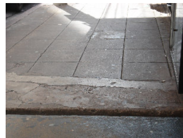
Figura 11 – Vão de 8cm na calçada
