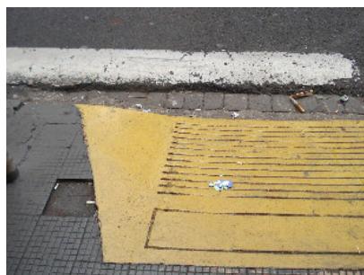
Figura 5b - Detalhe da via em estado irregular
