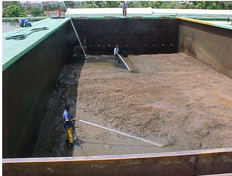
Fig. 1 Procedimento de limpeza dos tanques de decantação e desperdício de água já tratada
