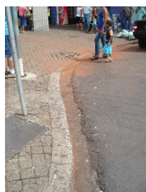
Figura 3 – Estragos na guia rebaixada
