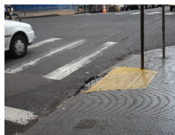
Figura 4 – Rebaixo de guia fora de norma e irregularidade no asfalto
