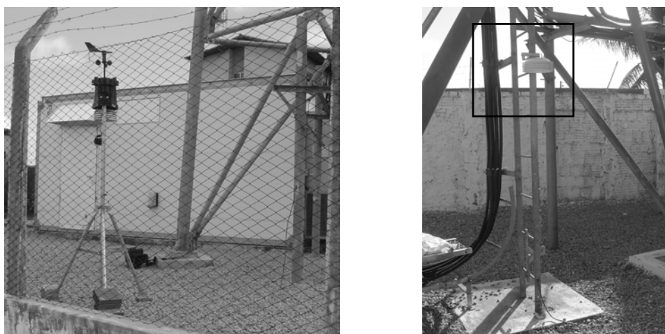
Fig. 04 e 05 – Dois tipos de equipamentos instalados. Uma estação meteorológica e um testor com proteção plástica.
