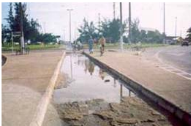
Fig. 2 Pavimento danificado da ciclovia
