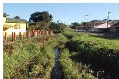
C: Local da antiga captação de água de São Carlos. Curso com erosão e assoreamento.
