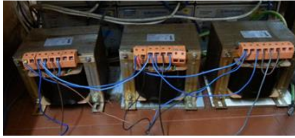
Figura 5.31. Transformadores monofásicos de 11 kVA utilizados para ligação do andar de potência à rede elétrica.
