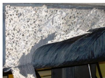
Por destacamento do reforço de CFRP NT-SH-100
