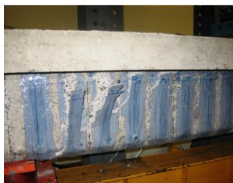
Por destacamento do reforço de CFRP NT-ST-35
