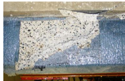
Por destacamento do reforço de CFRP NT-SH-200
