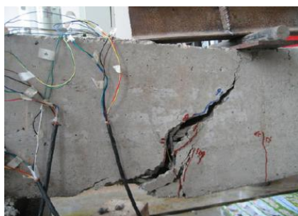
SR1 - Rotura por corte
