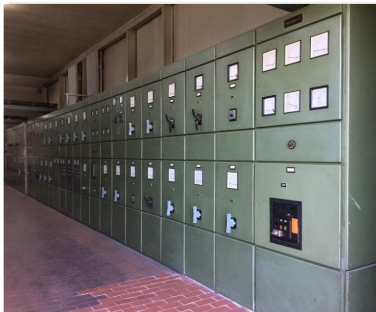
Figura 3.10. Quadros gerais de baixa tensão no PT.
