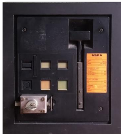
Figura 3.12. Disjuntor geral do QGBT1.
