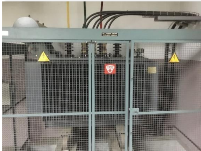
Figura 6.5. Transformador da CMH.
