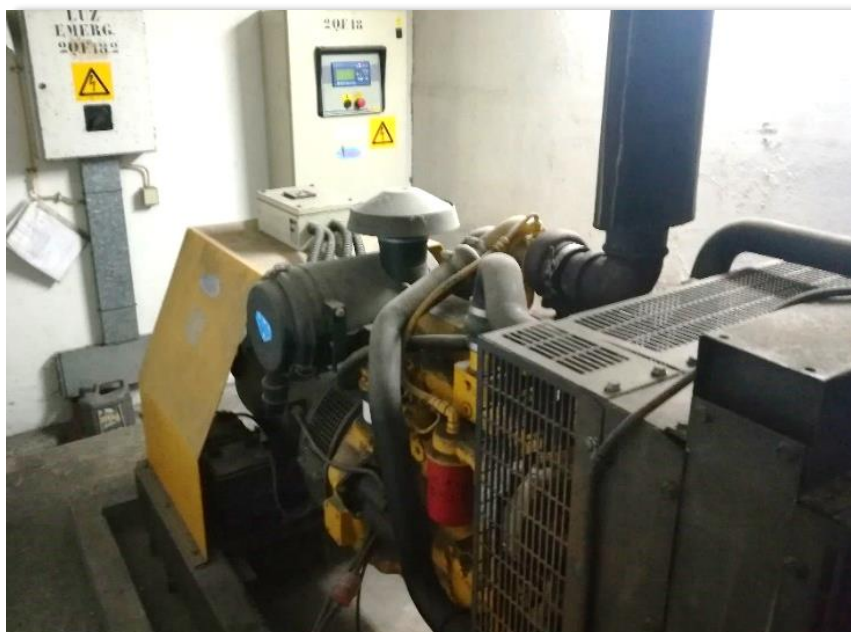
Figura 5.1. Grupo gerador de emergência.
