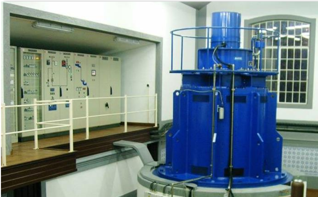
Figura 6.4. Grupo gerador da CMH.
