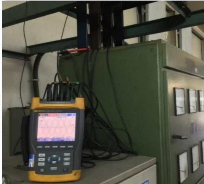
Figura 3.17. Monitorização aos QGBT.
