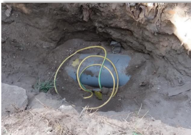
Figura 3.59. Vala onde foi encontrado o cabo interrompido de ligação à terra de serviço.
