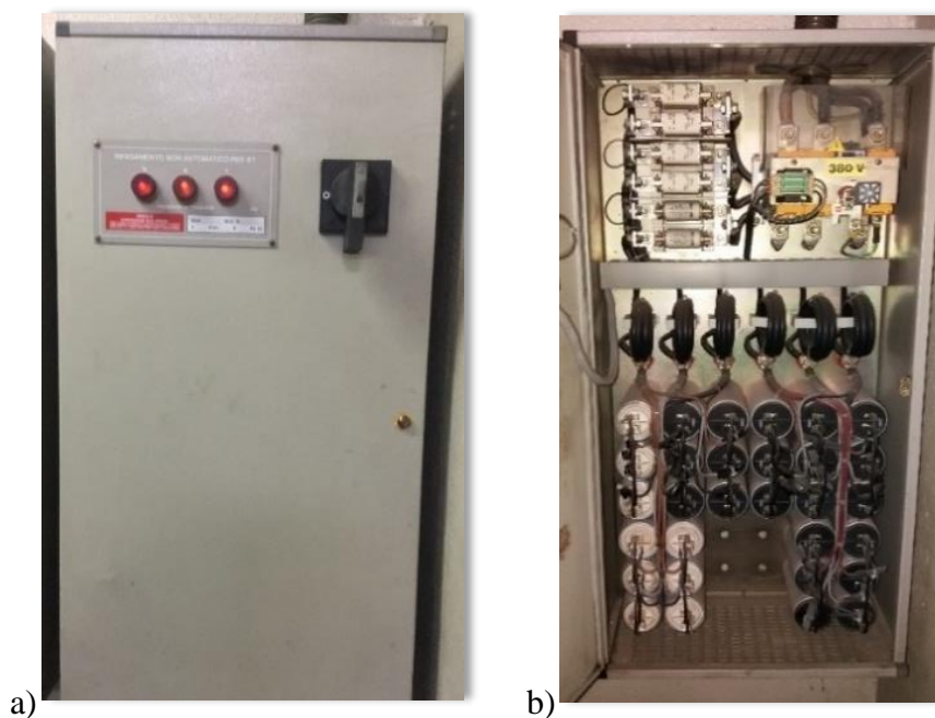
Figura 3.16. Baterias de condensadores de capacidade fixa: a) Vista exterior; b) Vista interior.
