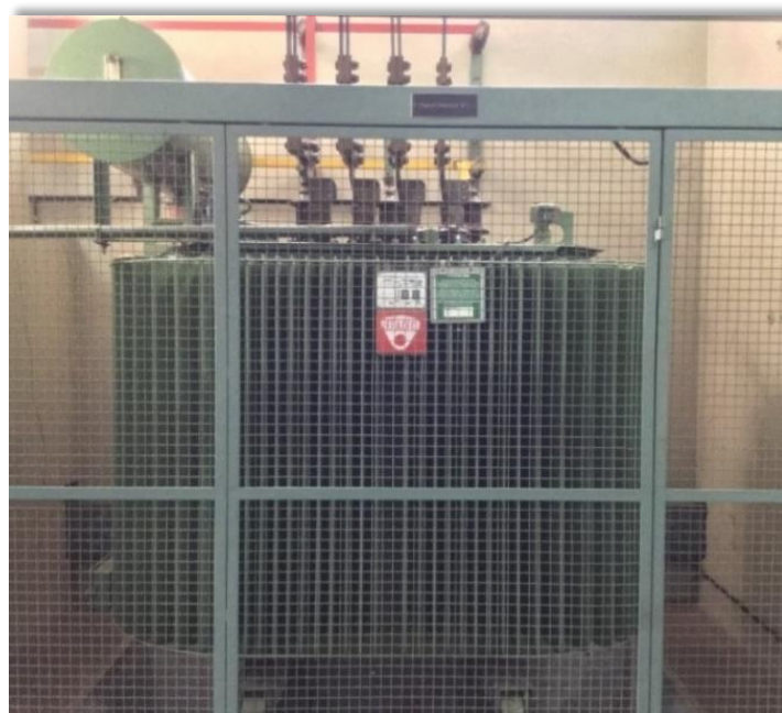
Figura 3.5. Cella do transformador nº3.
