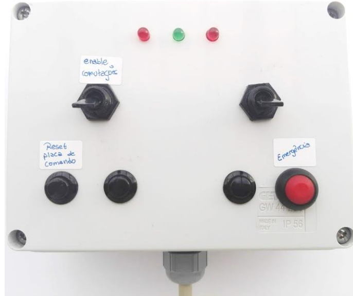
Figura 4.12. Caixa de comando.
