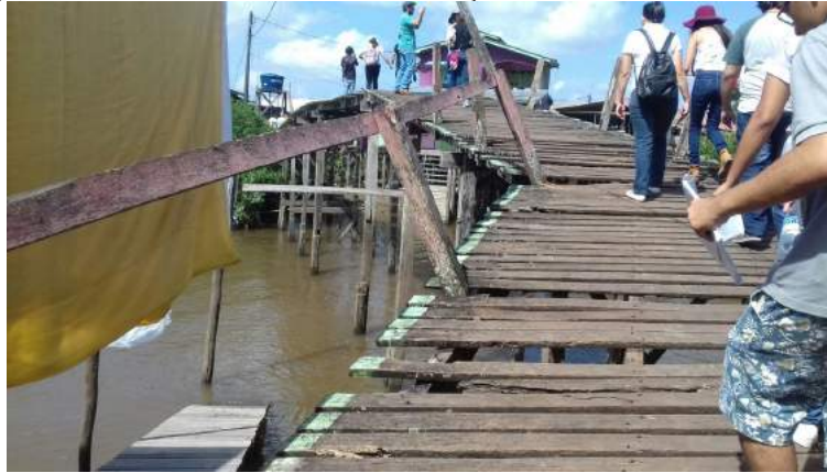
Figura 3. Pontes em mau estado de conservação dificultam a mobilidade no local.
