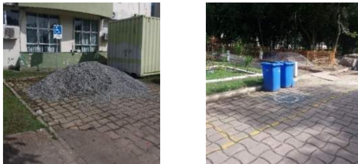
Figura 4. Materiais de construção e lixeiras nas vagas especiais
