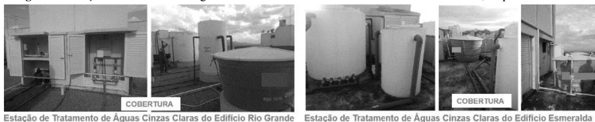
Figura 4. Estação de tratamento de águas cinzas claras dos edifícios Rio Grande e Esmeralda, respectivamente.
