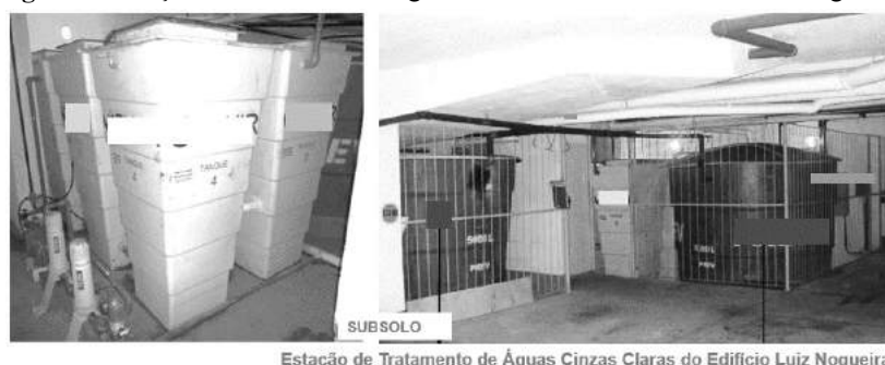
Figura 3. Estação de tratamento de águas cinzas claras do edifício Luiz Nogueira.
