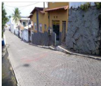
Falta de nivelamento entre as calçadas
