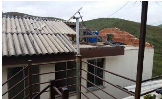
Figura 5 - Destelhamento por ação dos ventos
