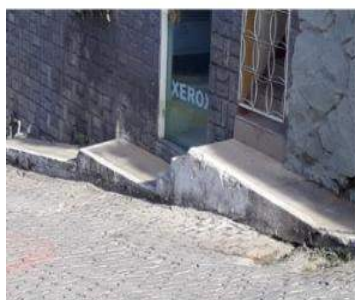
Falta de nivelamento entre as calçadas
