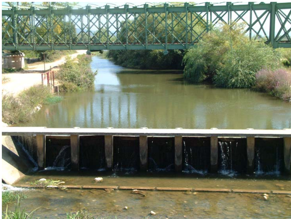
Figura 4.3 – Rio Arunca: estrutura de controlo de descargas no rio Mondego
