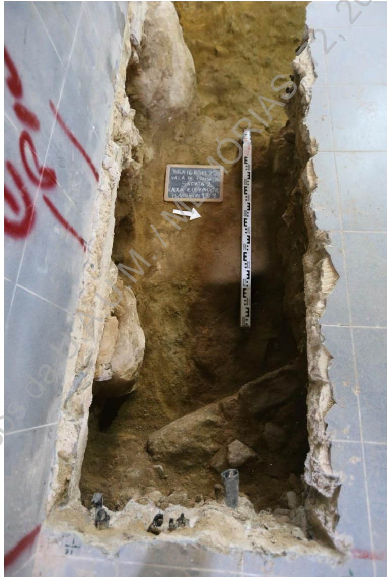
Foto 35 (IMG_1718) – Aspeto final da escavação para implantação da sapata 2 - pormenor de muro UE 019 (E/O).
