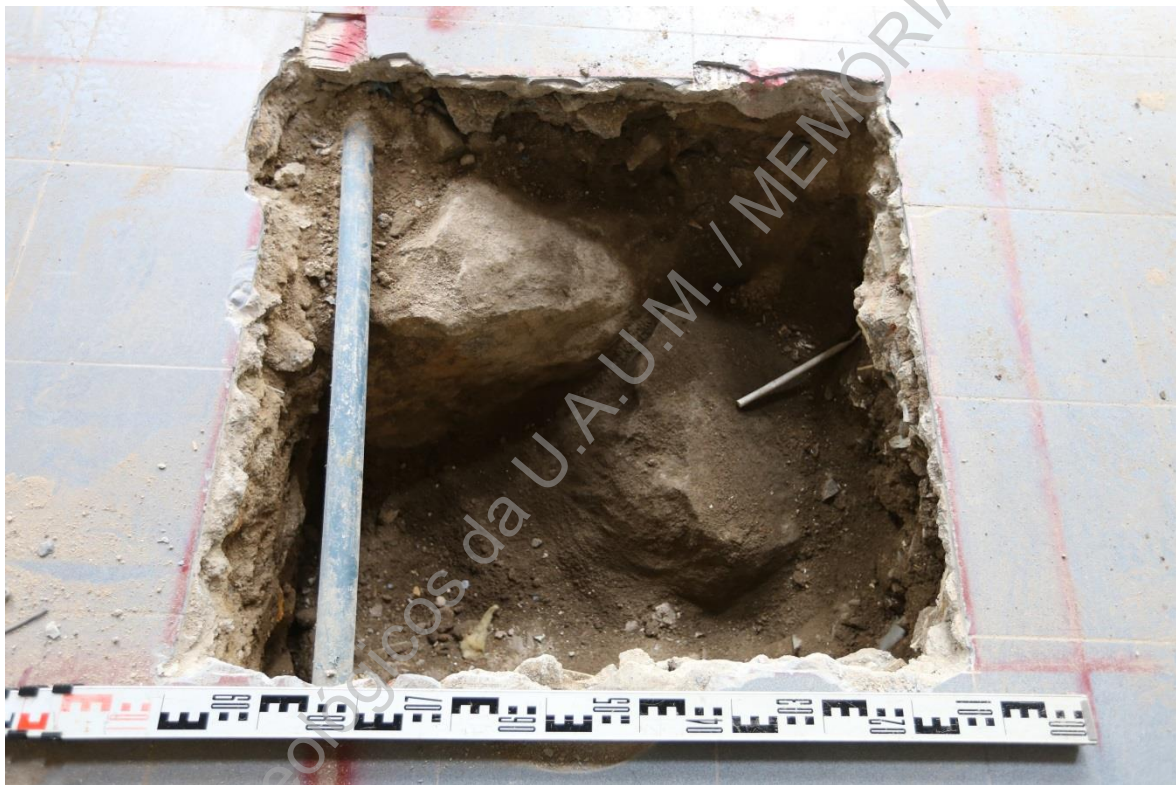
Foto 42 (IMG_1761) – Aspeto final da escavação da vala para implantação da sapata 4 (E/O).
