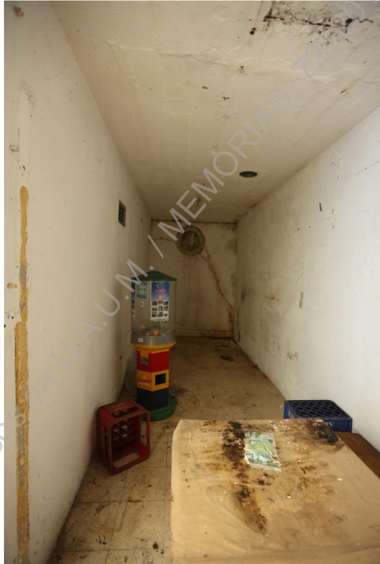
Foto 6 (Z45A7956) – Anexos construídos na área do logradouro do prédio (O/E).
