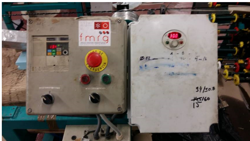
Figura 3-5 - Sistema de controle de velocidade da trançadeira e do sistema de tiragem.
