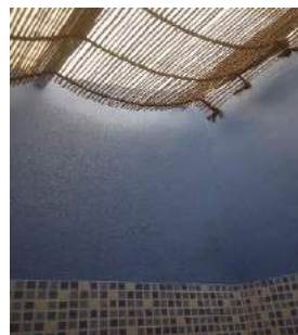
Figura 9: Iluminação natural em um banheiro por meio de cobertura translúcida
