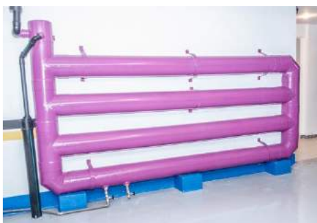
Figura 3. Reservatório de captação de água do ar condicionado.
