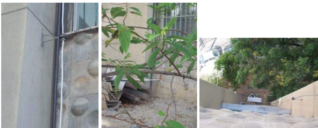
Figura 13: Sistema de Pára-raios. Fonte: Santos et al, 2014. Figura 14: Aterramento do Pára-raios. Fonte: Santos et al, 2014. Figura 15: Ar condicionado ao lado do pára-raios. Fonte: Santos et al, 2014.
