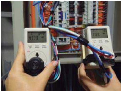
Figura 2. Registro da instalação de wattímetro nos circuitos. Fonte: Moura et al (2013).
