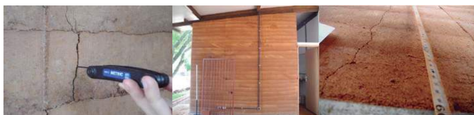
Figura 3. Etapas da medição das fissuras e trincas.
