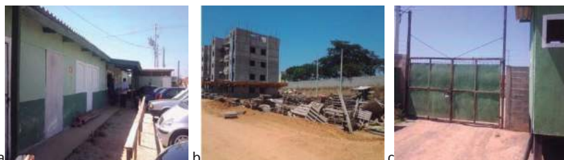
Figura 2. Instalações provisórias, falta de organização e portão de acesso na Obra B
