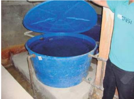
Figura 3: caixa com a água de condensação armazenada no subsolo (fonte: acervo pessoal do autor).
