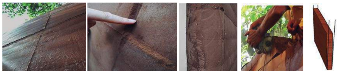
junta dos moldes desnivelamento cortes com serra-mármore falta de prumo Figura 8. Marcas e deformações das paredes de taipa (imagem "falta de prumo" de BARRETO e AJIKI, 2015).
