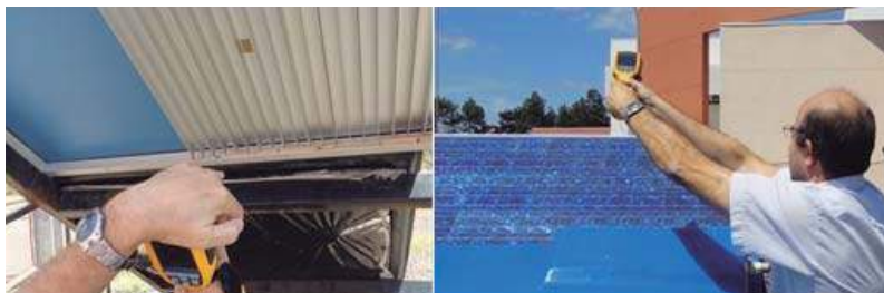
Figura 5. Brise-Soleil Fotovoltaico Montado. Fonte: Autores.
